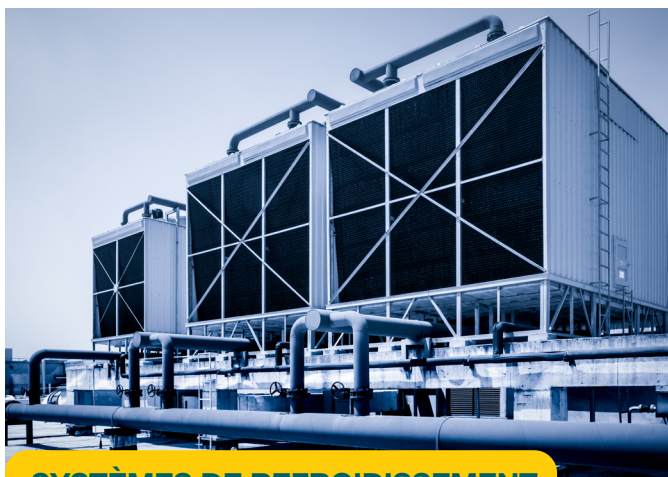
SYSTÈMES DE REFROIDISSEMENT
